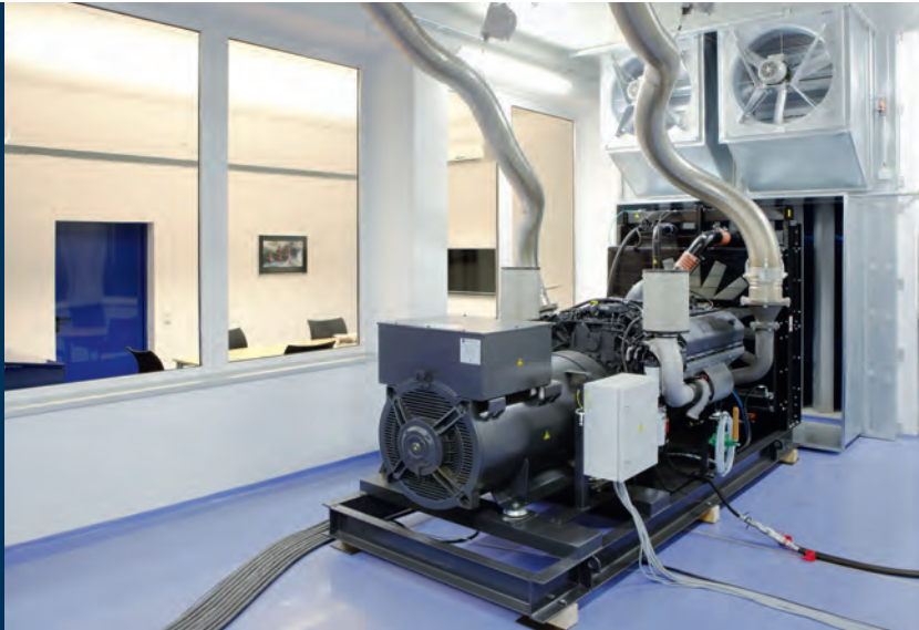
Notstromaggregat im Prüfstand – zuverlässig getestet unter Ernstfallbedingungen
