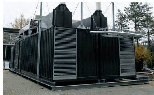
Sonderkonstruktion: 2x1.850 kVA Containeraggregat
