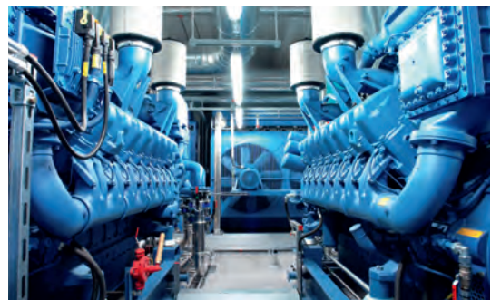
Parallel geschaltete Notstromaggregate im Einsatz
