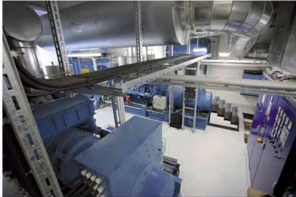
2 x 1265 kVA Aggregat für ein Rechenzentrum
