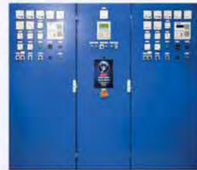
2 x 1265 kVA Notstromsteuerung für ein Rechenzentrum
